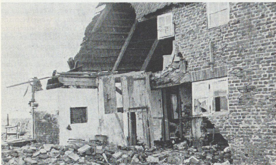
Zerstörtes Haus auf Hallig Hooge (s. S. 225 ff)
